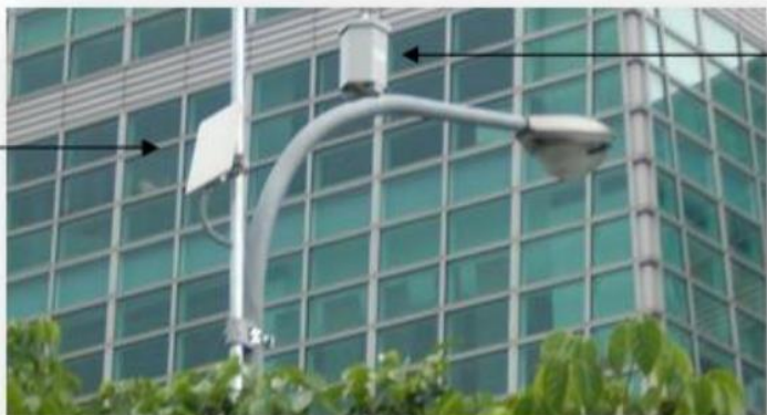
Vezeték nélküli backhaul link
